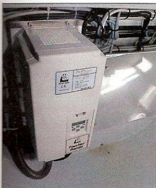
Le variateur. Installé dans la cabine arrière, le variateur est refroidi par le même circuit d'eau que le moteur.
